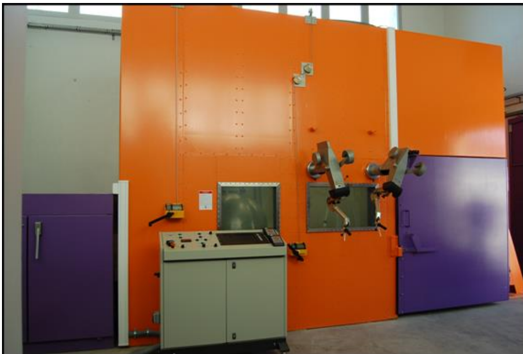
Figure 5 Face avant de la cellule de radioprotection
